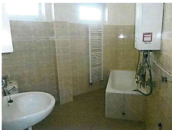
koupelna původní stav
